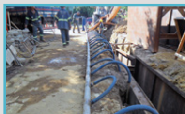
Estação Elevatória de Esgoto Itaquanduba (Sabesp).
