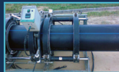
Adutora de Água em PEAD DE 450mm.
